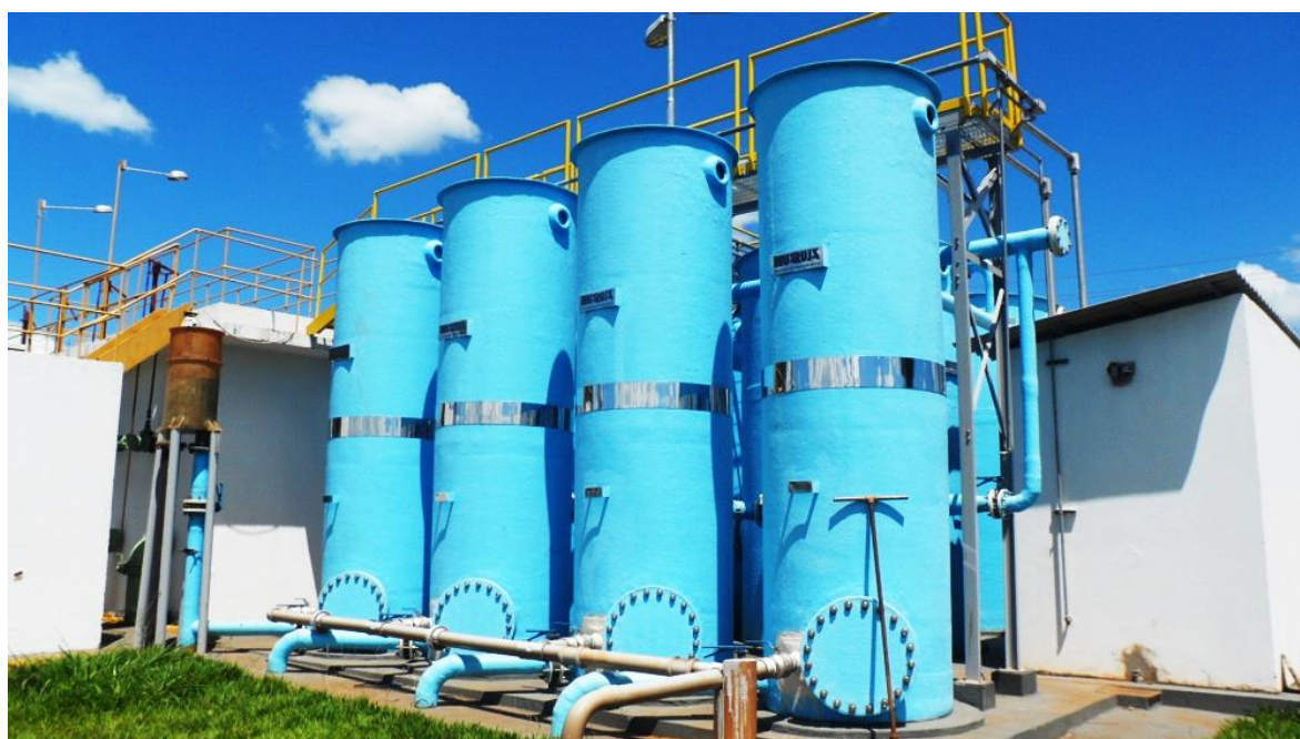
Figuras 178 e 179: Sistema de Abastecimento de Água – Fonte: PMR.
