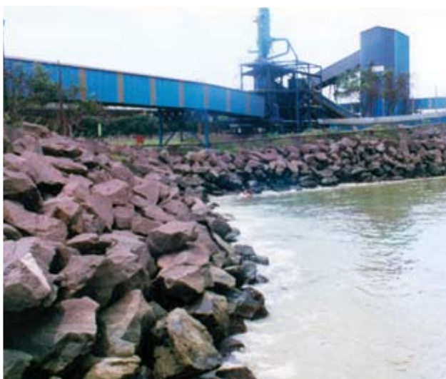
8.8. Região inferior de enrocamento com presença de óleo. Terminal da Companhia Vale do Rio Doce (ES). Lopes, Carlos Ferreira
